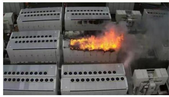
图 8：澳大利亚“维多利亚大电池”储能项目起火现场
